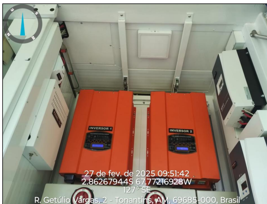
j) Figura 10 – Medição da amperagem dos Inversores;
