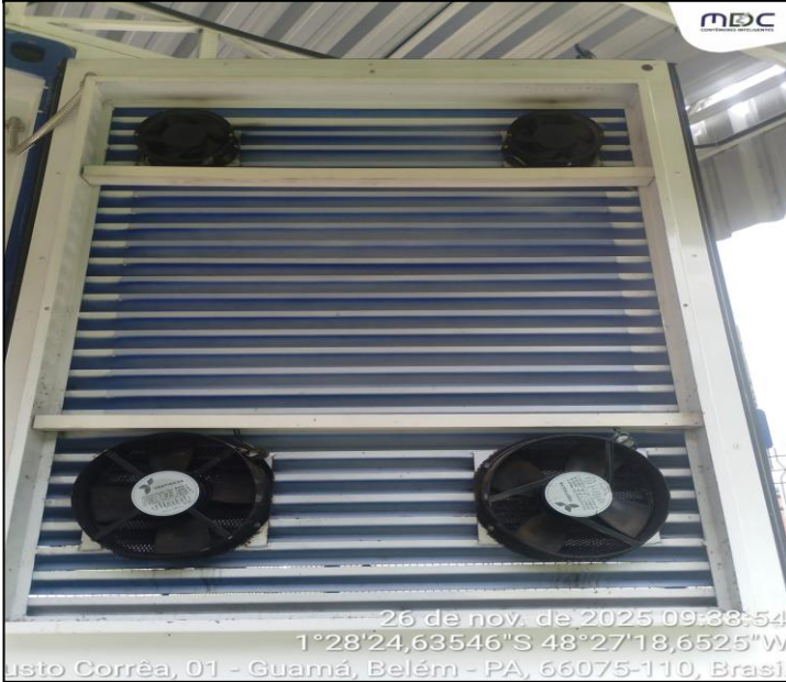
Ventiladores , apresentando condições adequadas de operação.
