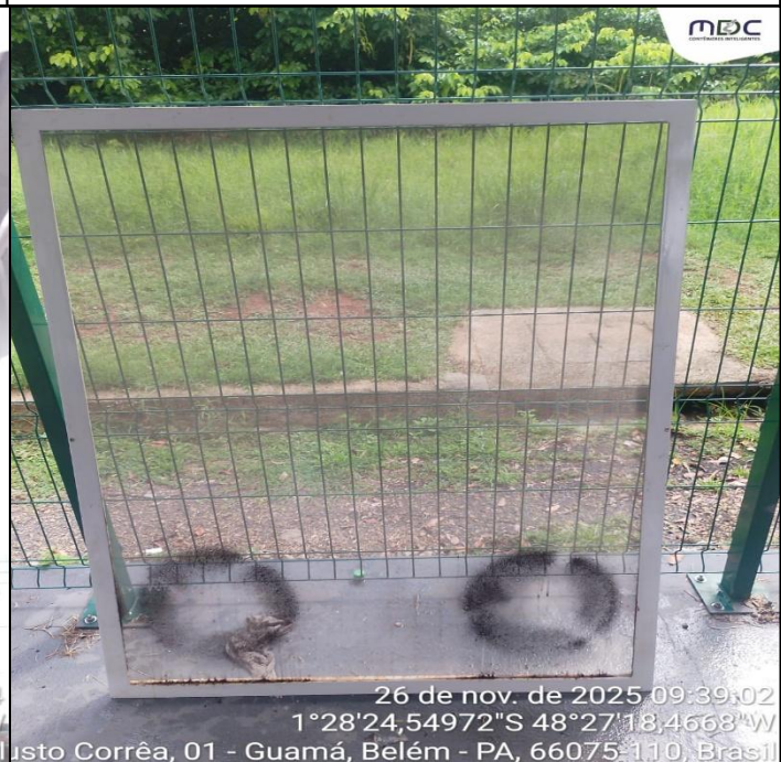
Filtros após o processo de limpeza , apresentando condições adequadas de operação.
