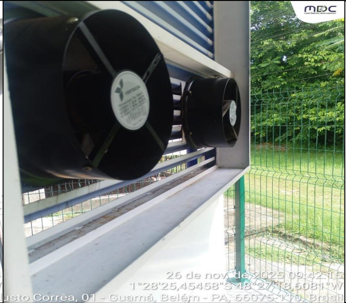
Ventiladores após o processo de limpeza , apresentando condições adequadas de operação e restabelecimento da eficiência do sistema de exaustão.
